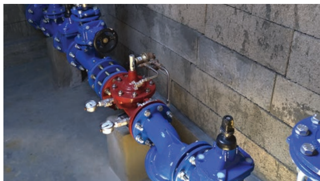
Stabilisateur de pression installé Avenue du Maréchal Joffre
