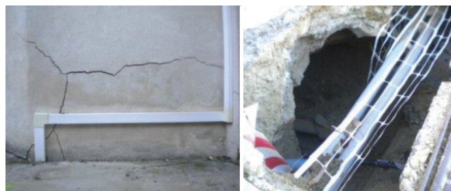
La cour intérieure de l'immeuble (à gauche) Le fontis (trou béant) découvert sous le trottoir
